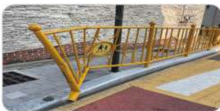
어린이보호구역 안전시설 파손
