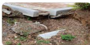
축제장 시설 파손
