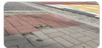
어린이보호구역 보도블럭 파손
